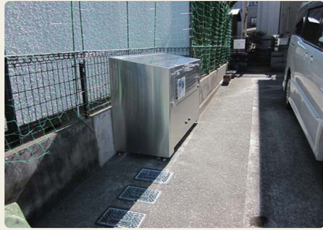
アパートオーナーさまのご要望で、住民さまの車に支障の無い大きさのEMDオーダーです。
