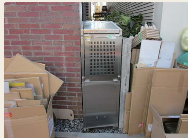
こんな狭い場所にも、アースボックスは設置出来ます。
