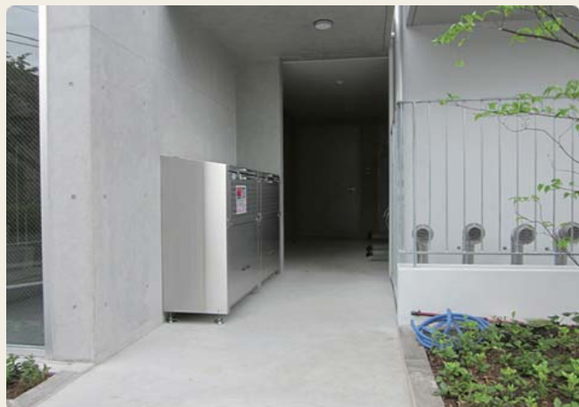
EMDSによって、今まで設置出来なかった通路などにも設置が出来るようになりました。
